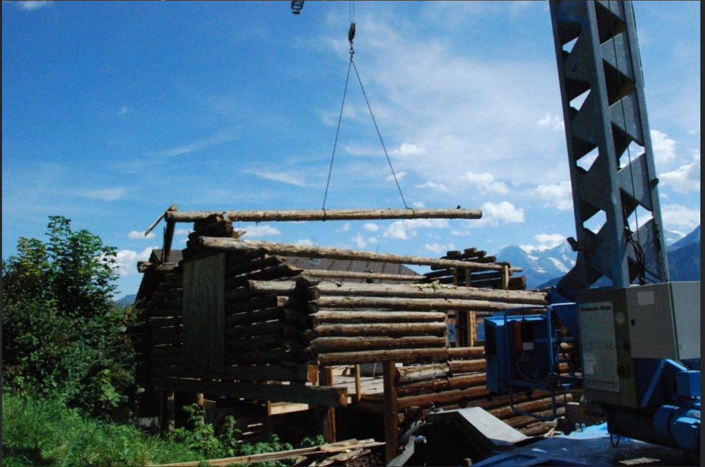
Der große Dachbalken passt in kein "Zwischenlager"
